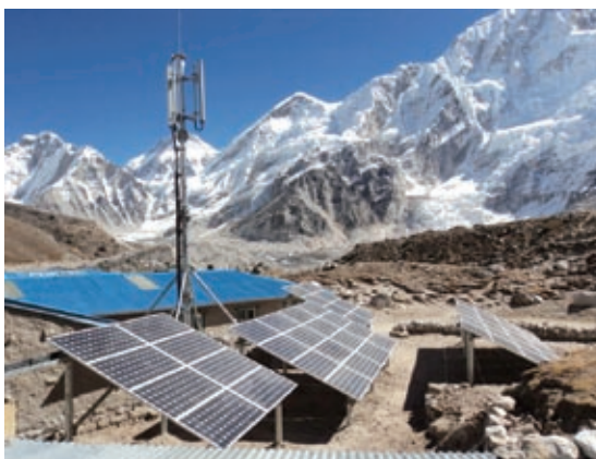
■ 本集團建設的全球最高海拔基站
