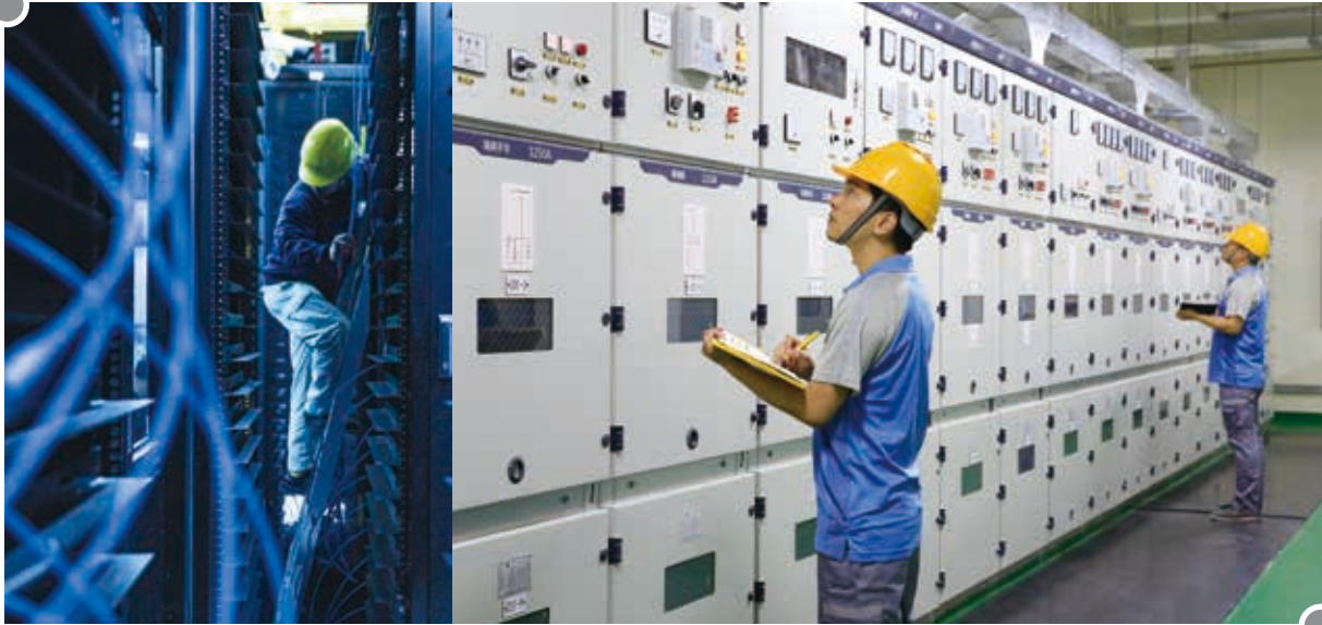
本集團承接IDC數據中心項目
