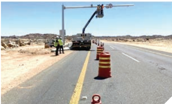
● 沙特某安防綜控公司道路監控項目
