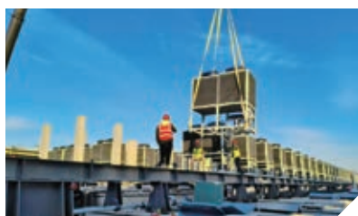
● 某第三方IDC服務提供商烏蘭察布雲計算中心基地項目
