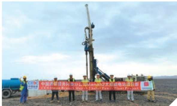
● 阿曼某地區光伏發電項目
